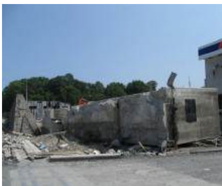
のコンクリート躯体が横倒し！
